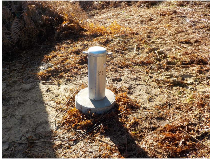
Tête de piézomètre terminé
